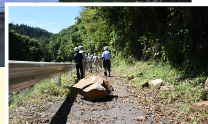
9 月 7 日に現地を視察。道路には無数の大きな落石がありました
