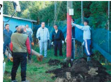
9月の台風で倒壊した円子小学校校庭の照明用のコンクリート柱を
