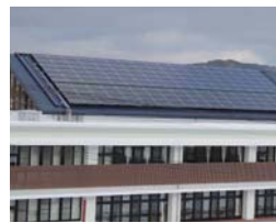
校舎の屋根に設置した太陽光パネル
