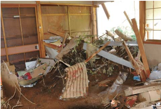
家屋への土砂流入②
