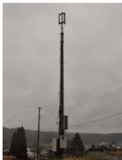
基地局整備が進むと携帯電話の通信エリア拡大につながります（写真は、簡易局のイメージ）
