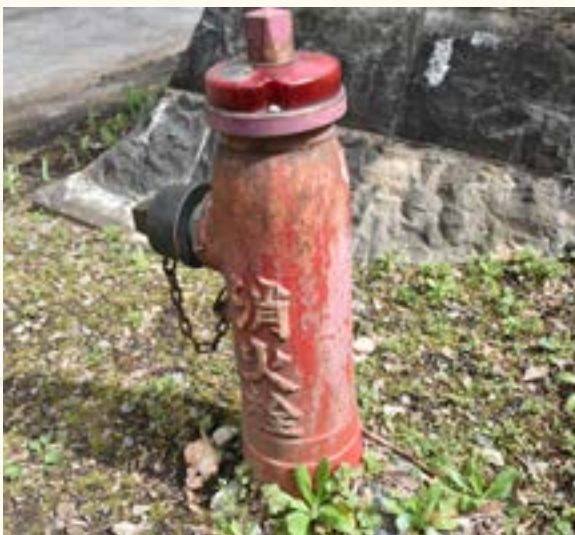
消火活動に使用される消火栓
