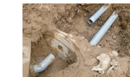
破損した水道管の例
