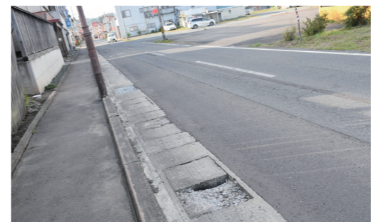
損傷している側溝の蓋
