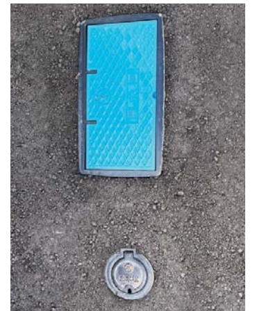
↑水道メーターボックス（上） と止水栓（下）
