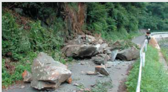
落石により通行止めとなった町道下晴山貝喰線
